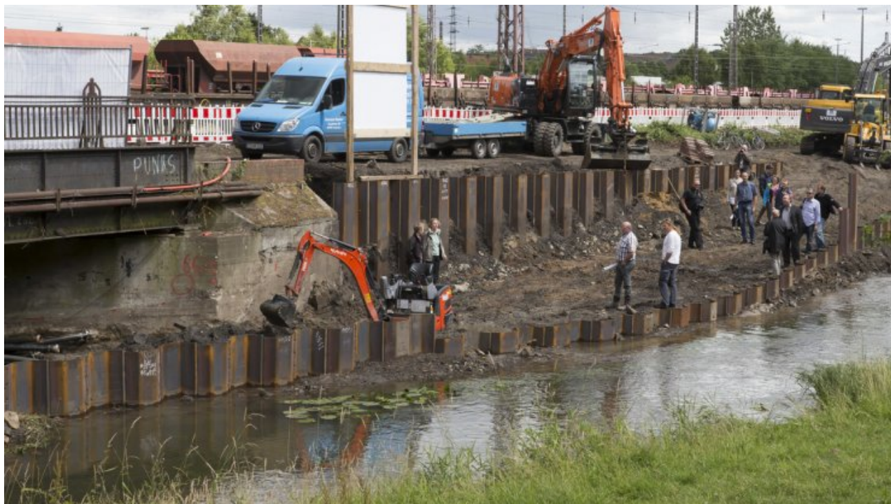
Die Bauarbeiten für den letzten Abschnitt des Haseuferweges zwischen Osnabrück und Bissendorf haben begonnen. Foto: Gert Westdörp
